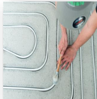
Chauffage de sol avec fraisage
