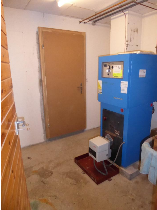
Chaudière à mazout
